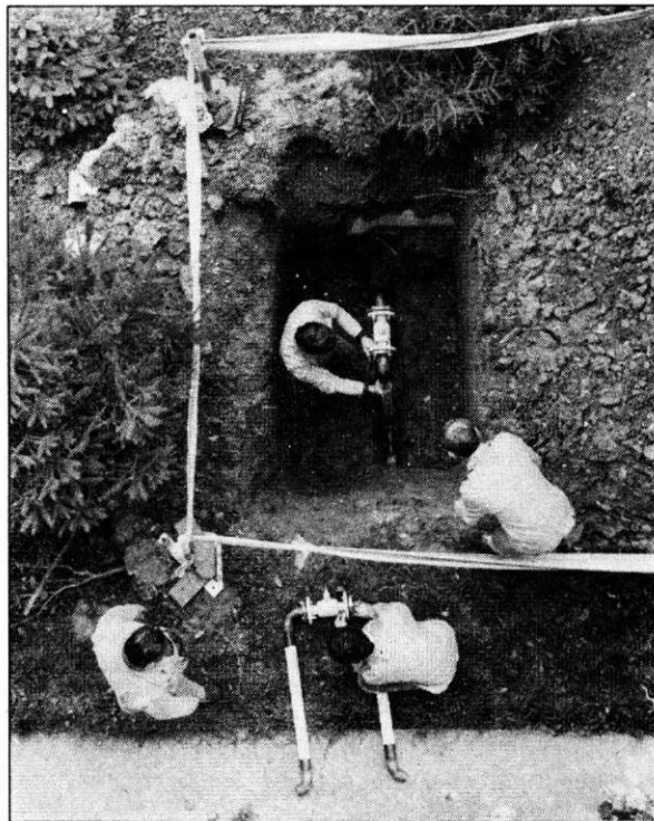
Közel másfél milliós költséggel cserélte ki a KOGÁZ a Keleti-városrészt gázvezetékeinek hagyományos vízzárta. A munkálatokat az elavuló rendszer, valamint a biztonságosabb gázellátás tette szükségessé.
